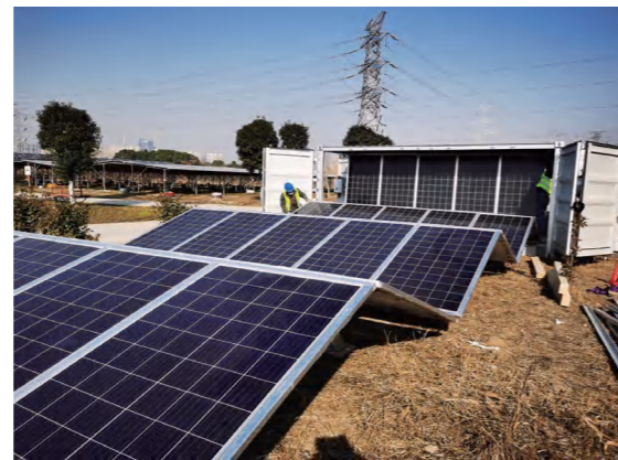
④ Unfold Solar PV Array
