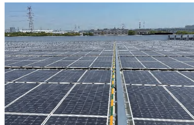
无锡锡山 积水塑料850kW彩钢屋顶 (柔性组件项目) (日企)
