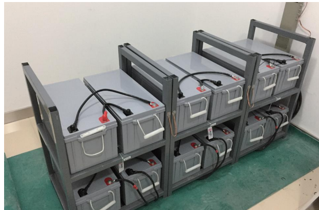
无锡蓝天热电厂18kW离网储能系统
