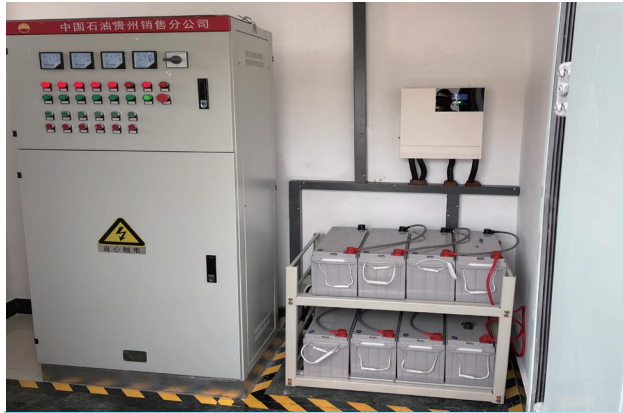
中石油贵阳加油站5.4kW离网储能系统
