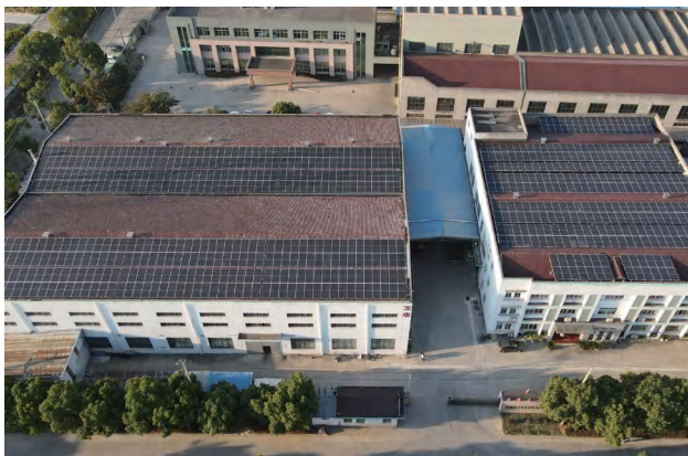
无锡惠山 万丰保护膜400kW瓦面屋顶 WUXI-400kW
