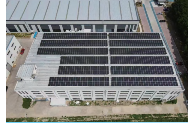
无锡滨湖 源清动力1.1MW水泥屋顶
