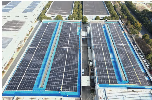
无锡惠山 东宇东庵1MW彩钢瓦顶 (韩企) WUXI-1MW
