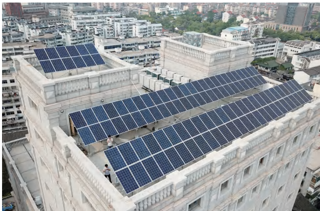
无锡梁溪 人民法院30kW水泥屋顶 WUXI-30kW
