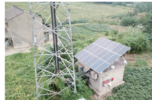
无锡惠山 5.76kW通讯铁塔
