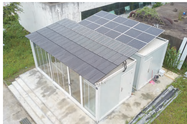
无锡惠山 7.8kW集装箱光伏储能系统
