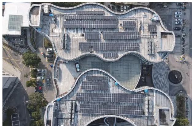
无锡梁溪 无锡俱崇安家居创意园220kW 水泥屋面
