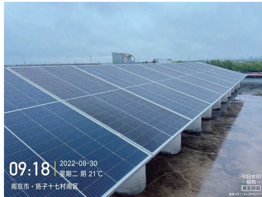
南京 扬子小学5kW/20kWh光伏储能 (铅酸)
