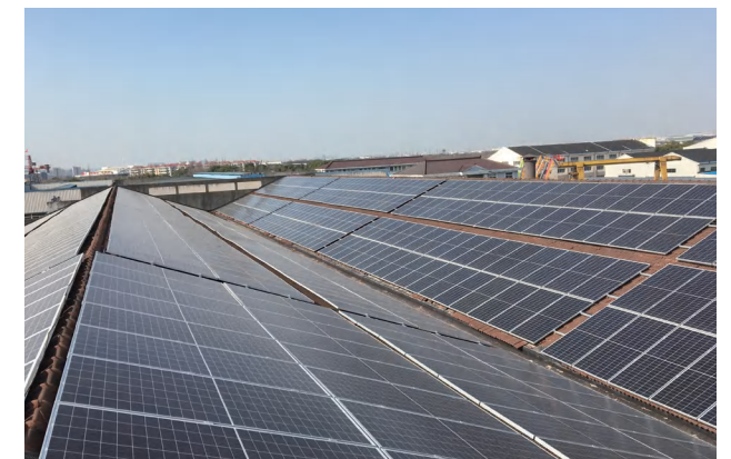
无锡新吴 保瑞特850kW瓦面屋顶
