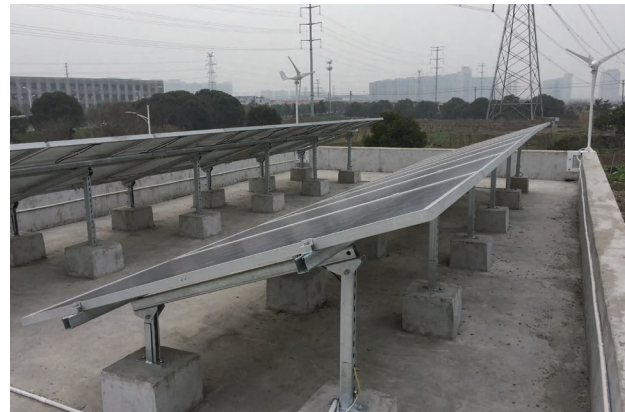
无锡惠山 5.4kW风光互补储能系统
