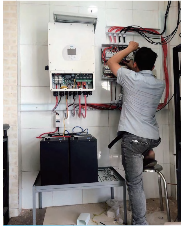
越南 5kW/10kWh光伏储能 VIETNAM-5kW/10kWh
