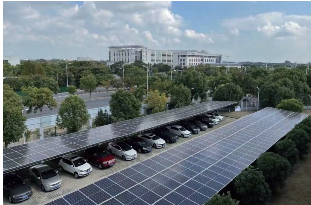
无锡新区 安普瑞斯200kW水泥屋顶+车棚 (美企)
