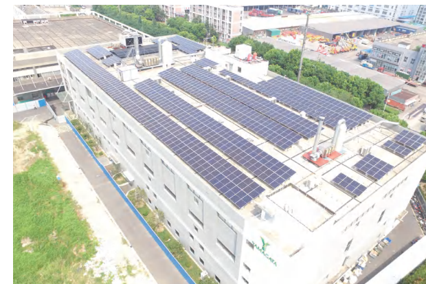
无锡锡山 山形印刷324kW水泥屋顶
